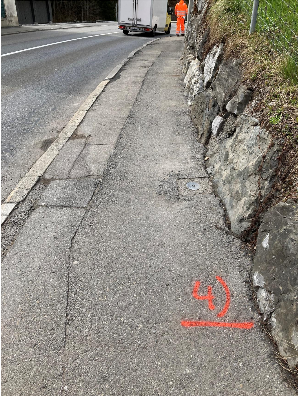
Der Belag des Trottoirs der Zugerstrasse in Neuägeri muss stellenweise repariert werden.
