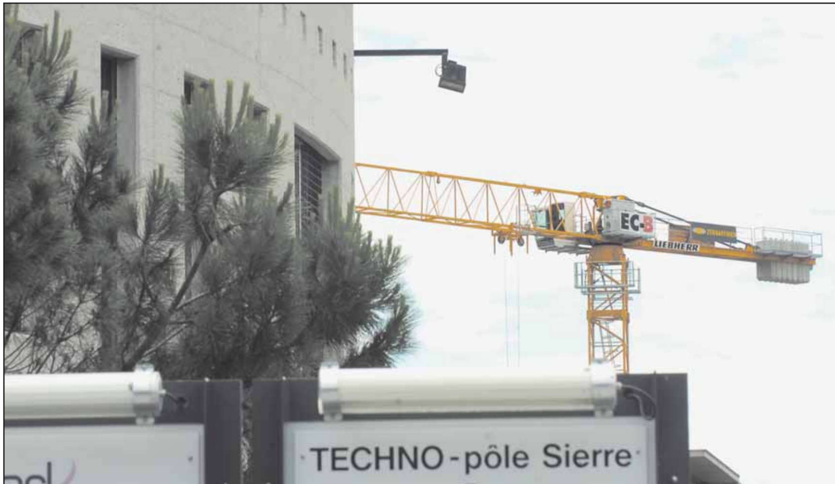
Le Techno-Pôle de Sierre devrait bientôt pouvoir poursuivre sa croissance. Le Grand Conseil a accepté hier d'entrer en matière sur une participation financière cantonale de 3,75 millions de francs. Mais en tout, ce sont plus de 21 millions qui seront investis sur ce site. BITTEL
