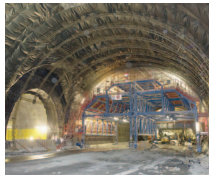
Du mauvais béton a été appliqué sur 600 mètres dans le tube sud du tunnel d'Eyholz. Une grande pince le réduit en morceaux, avant qu'on puisse rebétonner la voûte du tunnel. BITTEL
