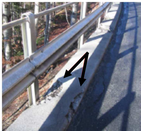
Figure 4 : Dégradation de bordures
