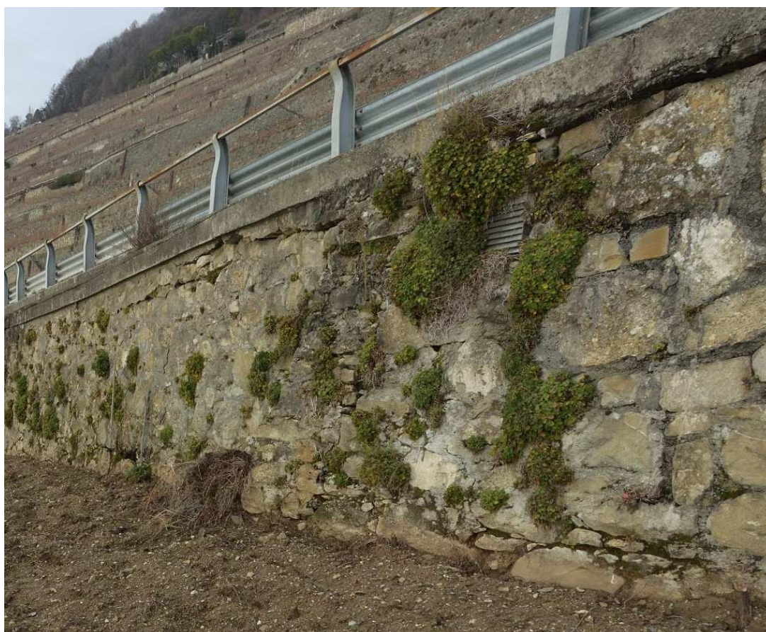
Fig. 16 : dégradations des murs en maçonnerie
