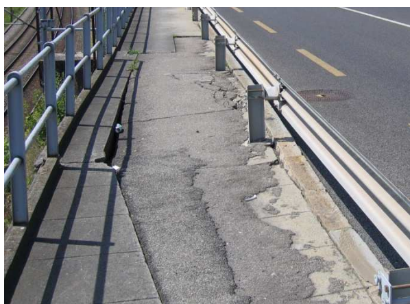
Fig. 5 : trottoir étroit et dégradé
