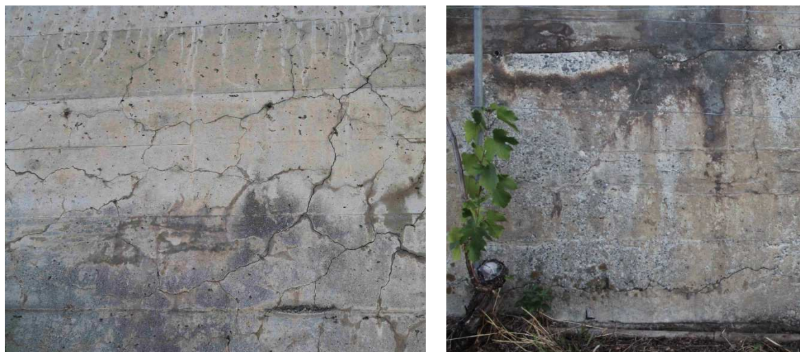
Fig. 15 : dégradations des murs en béton (RAG)
