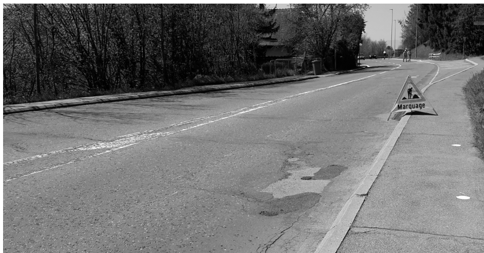
Figure 2 : Fissures et décollement du revêtement
