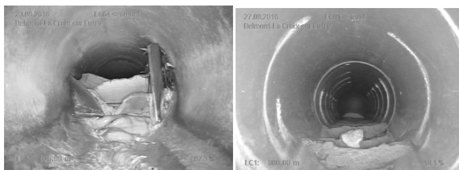
Figures 3 et 4 : Canalisations obstruées par le calcaire
