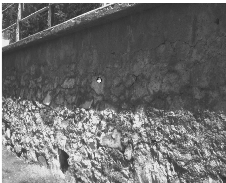
RC 719 Dispositif de sécurité à changer, couvertes et murs à entretenir
