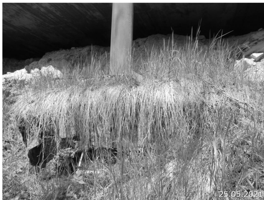
RC 706 Tassement sous la fondation
