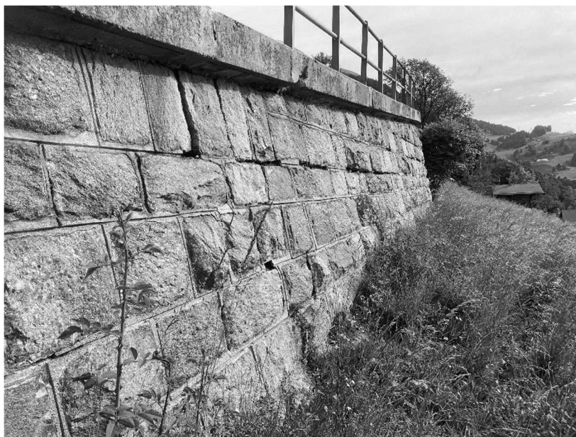
RC 709 Dispositif de sécurité à changer, couvertes et murs à entretenir
