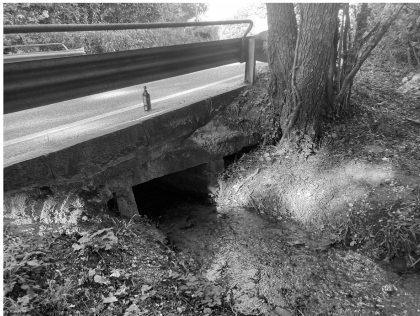
RC 29 Ponceau à remplacer
