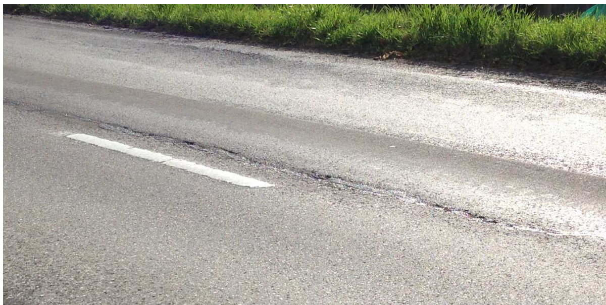
Fig. 2 : Chaussée déformée et fissurée
