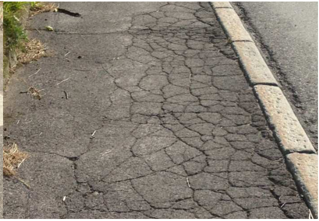
Fig. 4 : Trottoir avec revêtement déformé et fissuré
