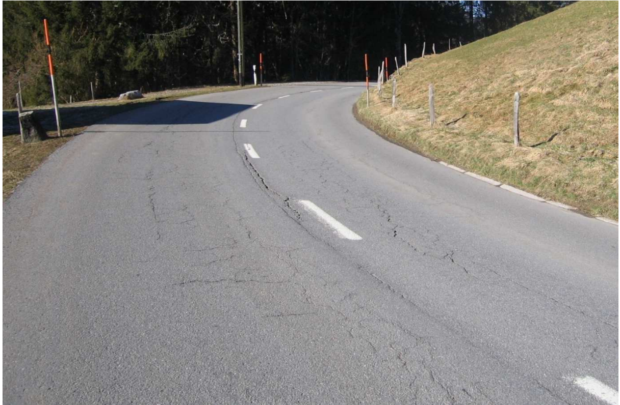
Fig. 2 Enrobé fissuré et manque de visibilité
