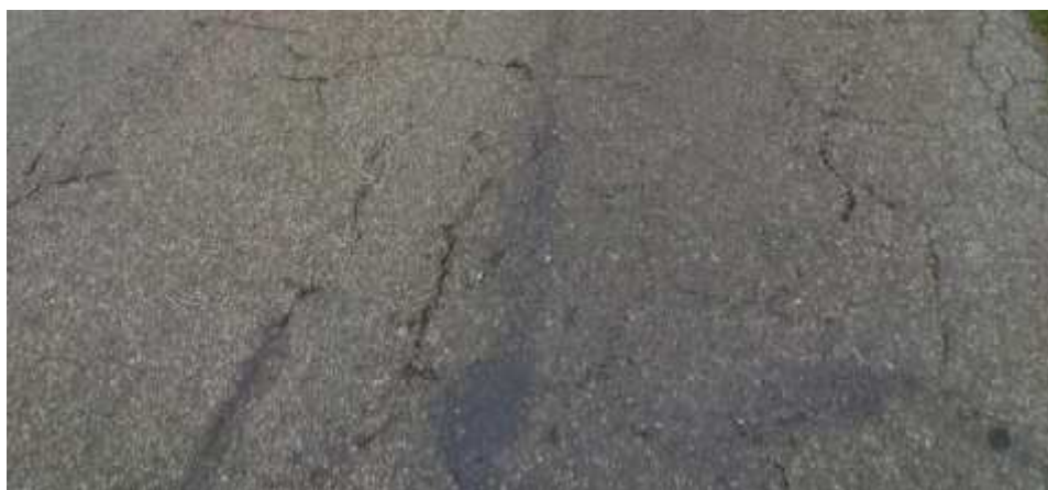
Figure 4 : Fissures dans le revêtement (voie direction Cugy)
