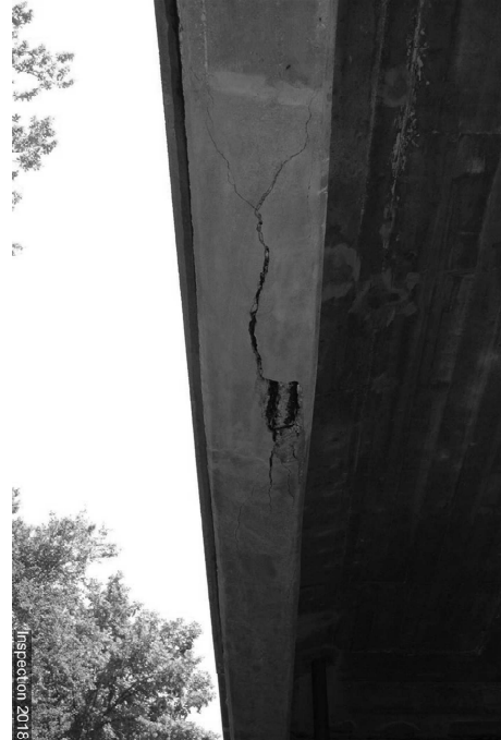
Photo 7 : fissure avec corrosion
