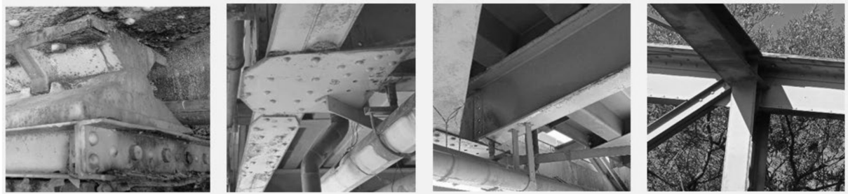
Corrosion de divers éléments de la structure
