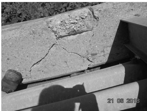
Eclat de béton sur bordure
