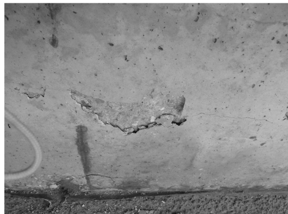
Eclatement du béton du mur amont
