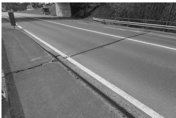
Joint de chaussée dégradé
