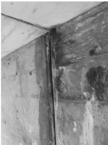
Corrosion des aciers du béton de la poutre aval.
