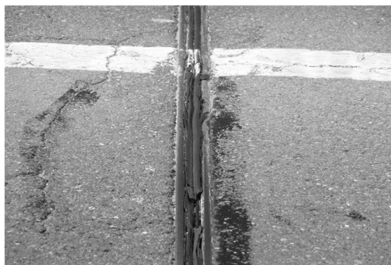
joint de chaussée dégradé, détail
