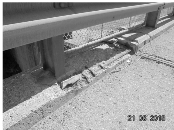
Bordure avec armature à nu et glissière non-conforme
