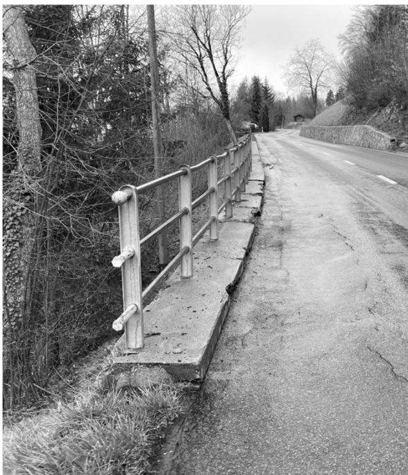
Garde-corps non conforme, bordure et chaussée dégradées
