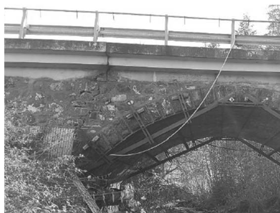
Fissures dans la maçonnerie du mur latéral
