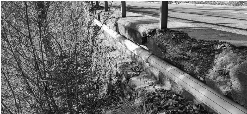
Longrines fortement dégradées sur mur en maçonnerie
