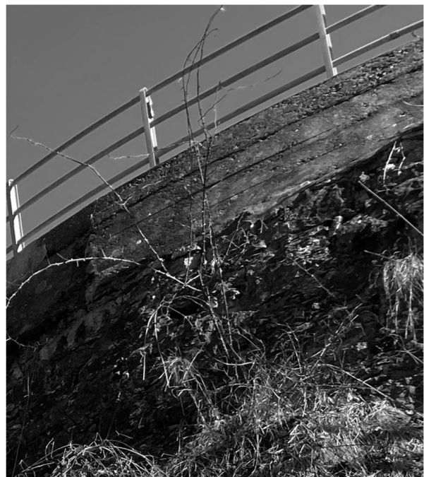
Mur en pierre et bordures à reprendre
