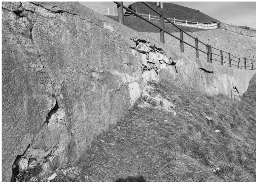
Figure 11 : Mur existant, partie est très dégradée
