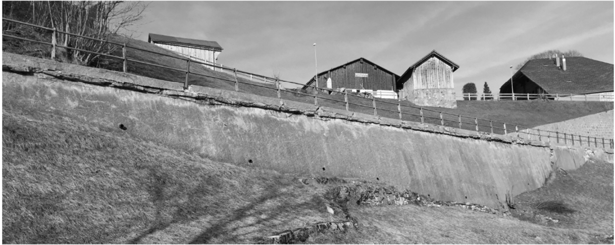
Figure 10 : Mur existant, partie centrale très dégradée au couronnement
