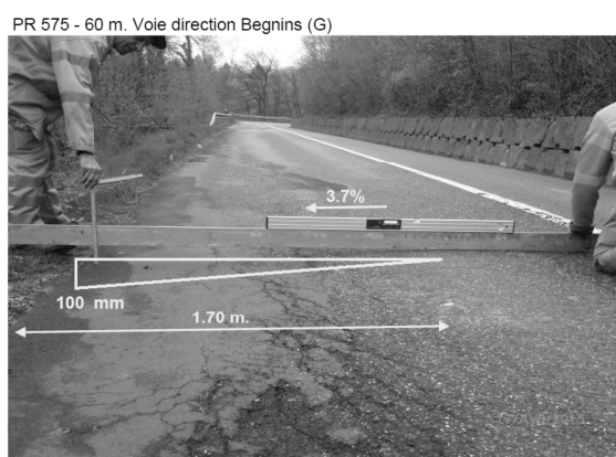
Figure 3 : Déformations du talus aval, mesures de terrain, en arrière-fond mur en blocs de béton
