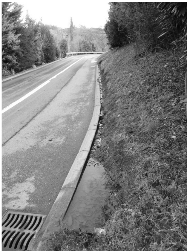
Figure 18 : Talus amont instable avec écoulement actuel des eaux
