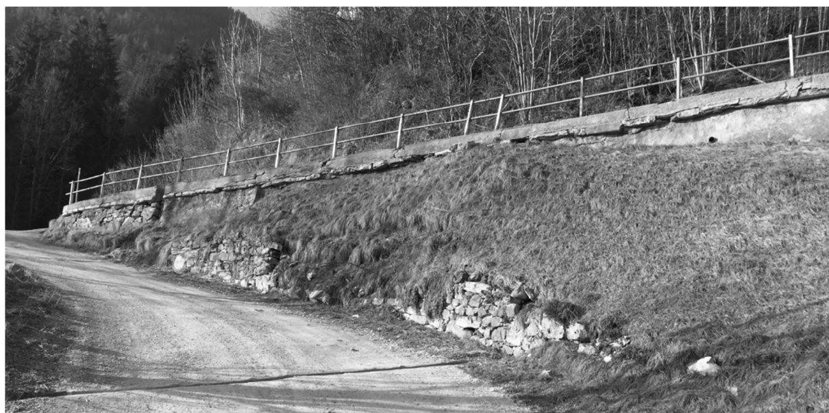
Figure 9 : Mur existant, partie ouest très dégradée
