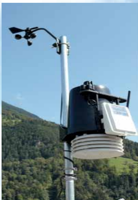
Abb. 1: Sensorstation auf dem Kollegi-Dach
