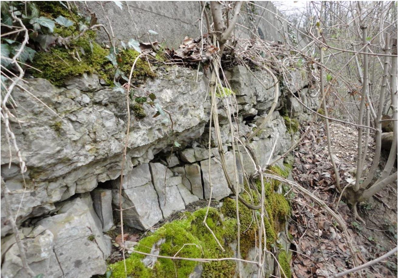
Schlechter Zustand der Natursteinmauern
