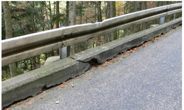
Schlechter Zustand Leiteinrichtung und Strassenabschluss
