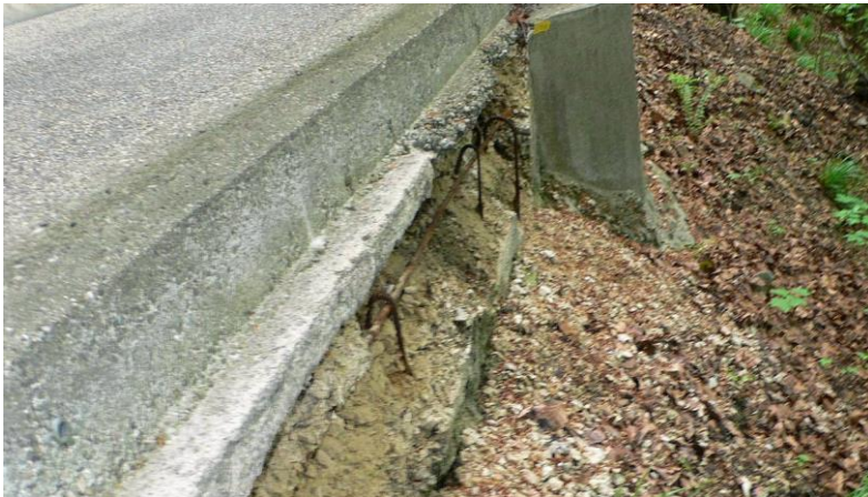
Schlechter Zustand der talseitige Stützmauer
