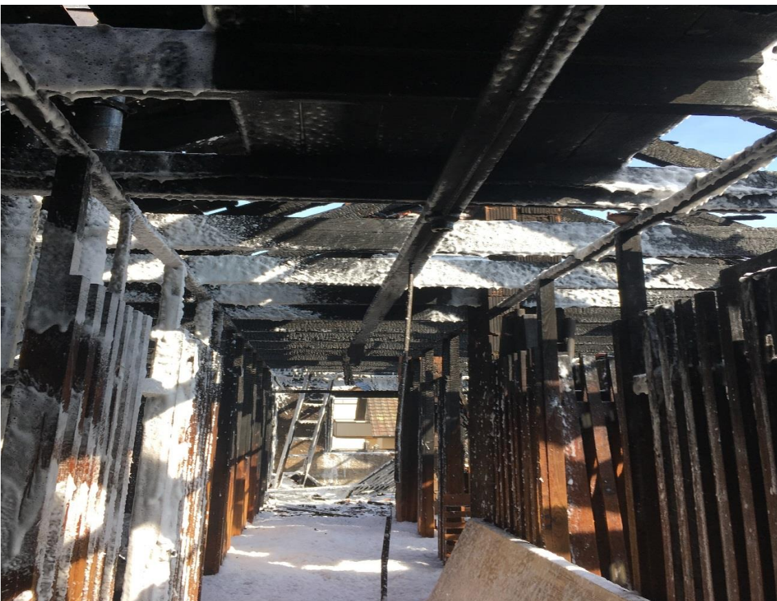
Bild Teilschaden Dachgeschoss (Brand Wohnhaus in Neuhausen)
