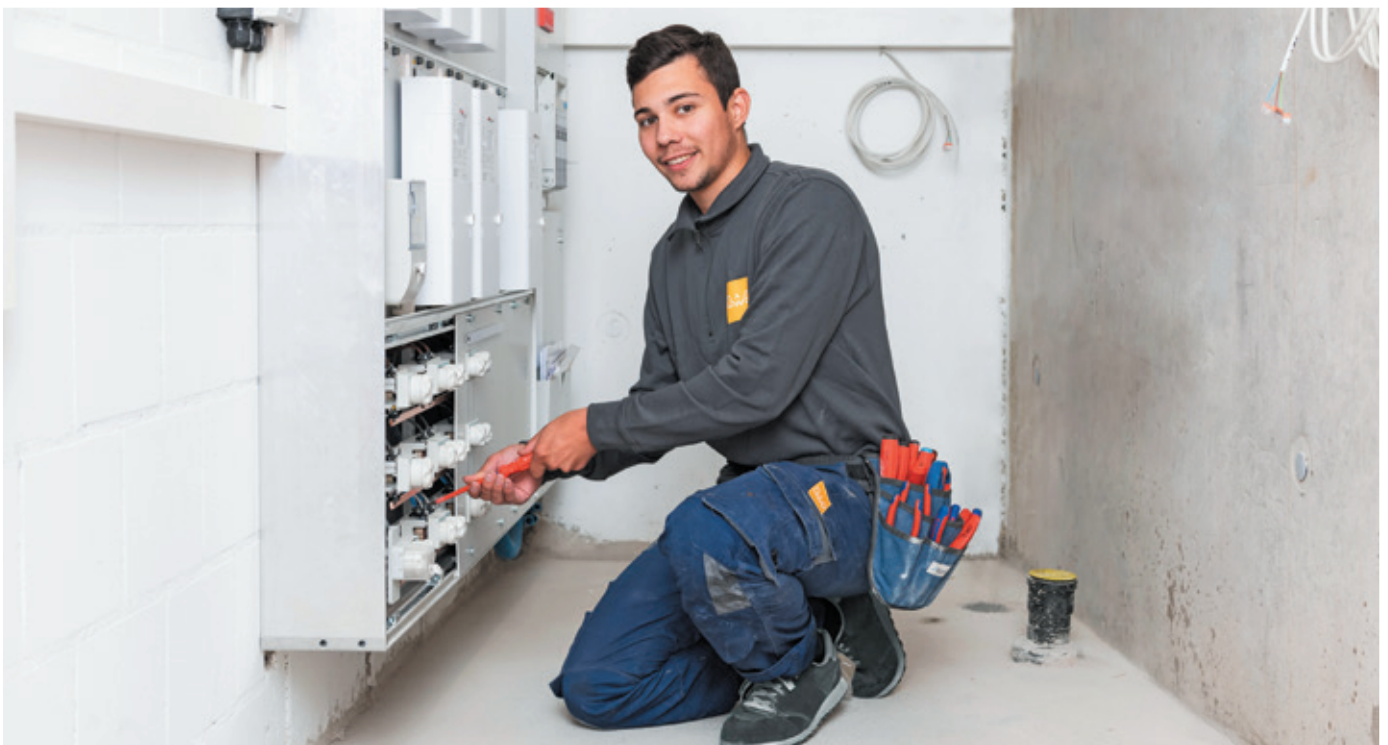
Janos Küchler aus dem Team der Elektroinstallateure schliesst auf einer Baustelle am Hauptverteiler die letzten Kabel an. Seine Arbeit als Elektroinstallateur wird immer abwechslungsreicher. Mehr und mehr geht es bei seinen Aufträgen nicht nur um den Einzug von Leitungen und die Montage von Steckdosen, sondern auch um elektronische Komponenten für die Gebäudeautomation.
