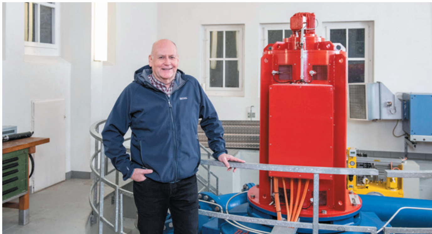
Die Kleinkraftwerke Kerns EWK gehören der Korporation Kerns. Sie hat mit dem Elektrizitätswerk Obwalden im Jahr 2015 einen Servicevertrag für die Instandhaltung der beiden Kleinkraftwerke abgeschlossen. Ansprechpartner auf Kundenseite ist Urs Bucher, Präsident der Verwaltungskommission Kleinkraftwerke EWK.
