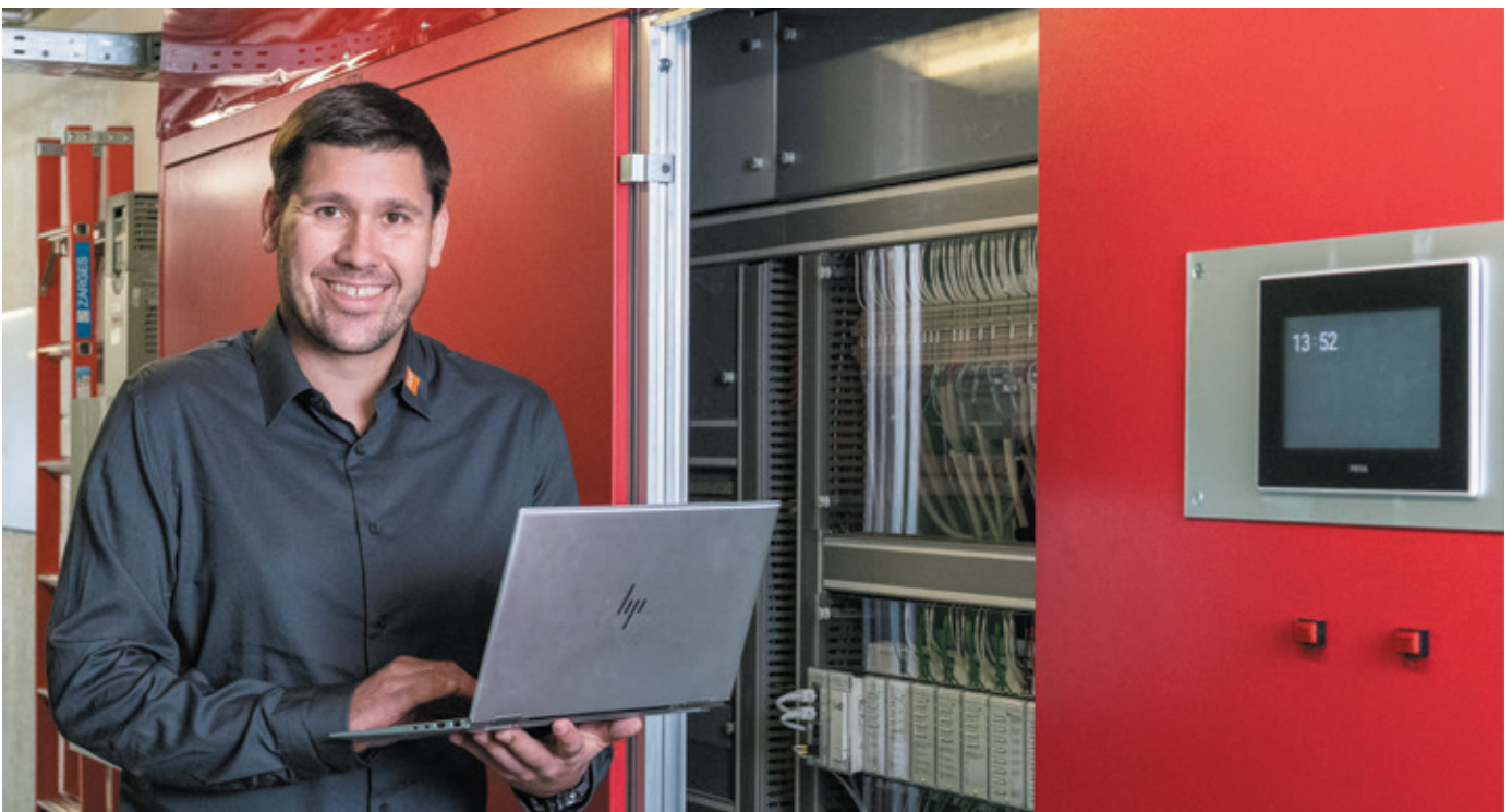
Michael Ineichen, Leiter Gebäudeautomation, überprüft und justiert das zentrale Managementsystem des Gebäudes bei einem Kunden. Damit werden die Heizung, die Warmwasseraufbereitung, die Lüftung, die Raumtemperatur, die Beleuchtung sowie die elektrischen Geräte zentral gesteuert und überwacht. Zum Serviceabonnement gehören auch die externe Überwachung und die allfällige Fehlerbehebung der Systeme.
