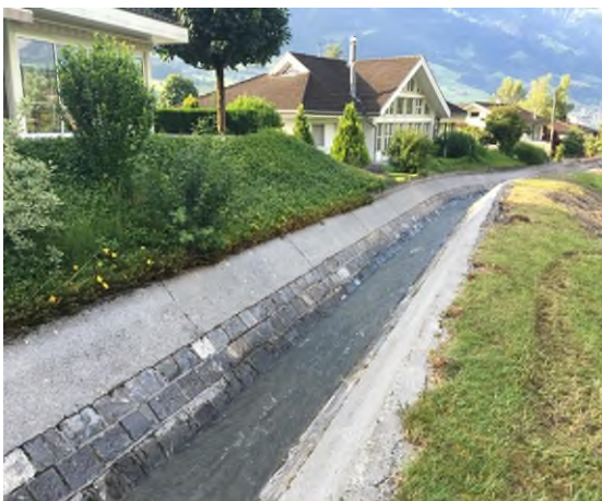
Abbildung 4: Betonschale / Pflästerung unterhalb der Wilerstrasse mit stark ausgewaschenen Fugen und stellenweise stark durchwurzelt.
