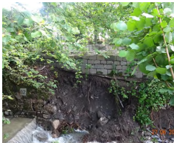
Abbildung 5: Gerinne unterhalb der Wilerstrasse mit stark erodierter Böschungsmauer.
