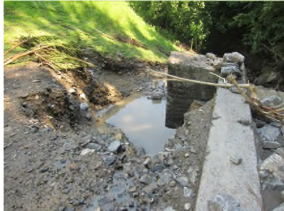
Abbildung 2: Hinterspülte Betonsperre im Bereich Wybergli. Das angrenzende Wohnhaus musste während dem Ereignis evakuiert werden.
