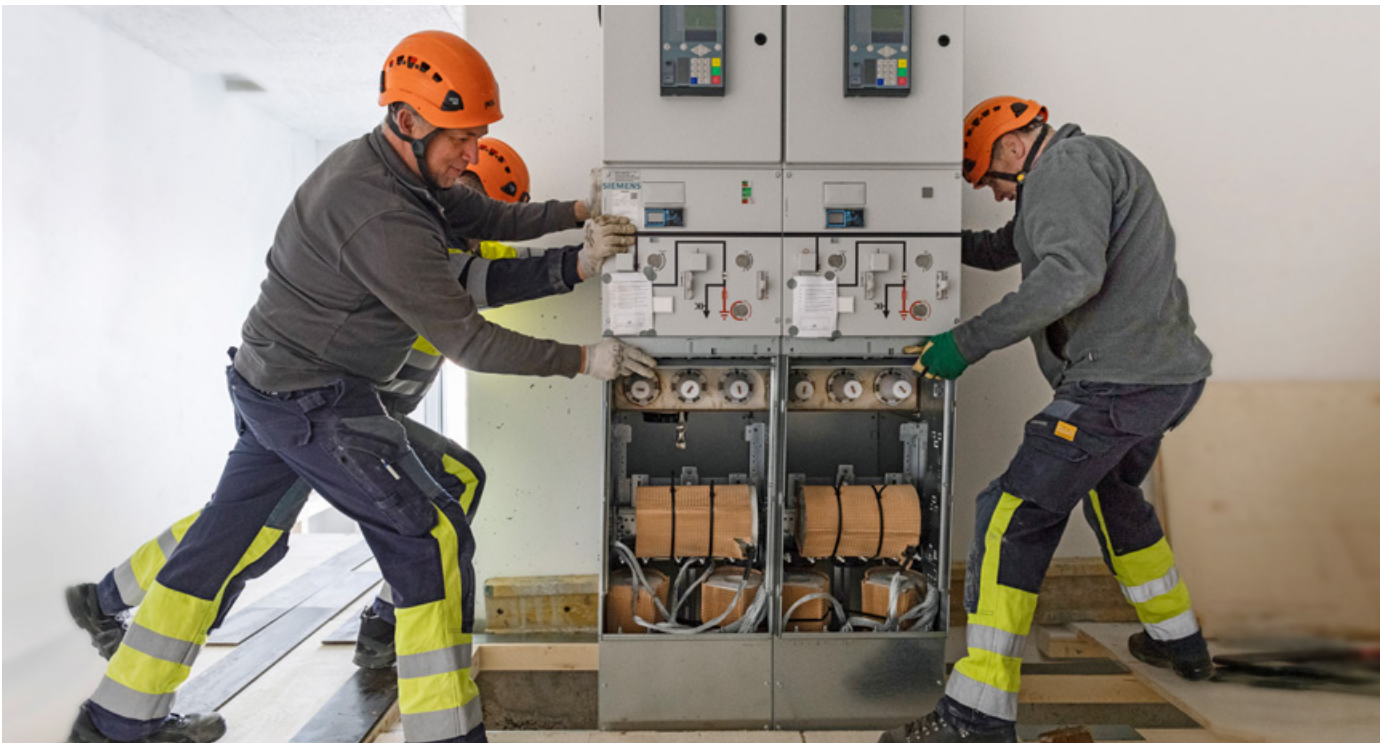
Die Buttisholzer Tschopp Holzindustrie AG baute in den vergangenen Jahren ein komplett neues Sägewerk auf. Zur Sicherstellung des hohen Energiebedarfs durfte das Elektrizitätswerk Obwalden die neuen Mittelspannungsleitungen und die Transformatorstationen liefern und installieren. Der Leitungszubau erfolgte in Zusammenarbeit mit der Baumeler Leitungsbau AG. Für die Installation der Transformatorstationen waren Markus Iten, Peter Flück und Marcel Langensand vom Netzteam verantwortlich.
