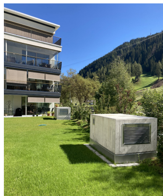
Vor Wassereintritt geschützte Lüftungsschächte.
