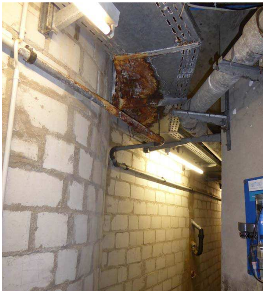
Bild: Leitungen im UG
