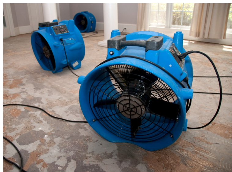
Wasserschäden verzeichnen eine hohe Schadenbelastung
