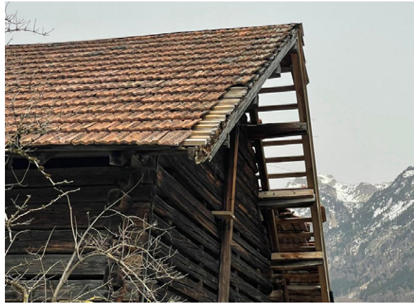
Sturmschäden an einem Stall im Däniberg, Thon
