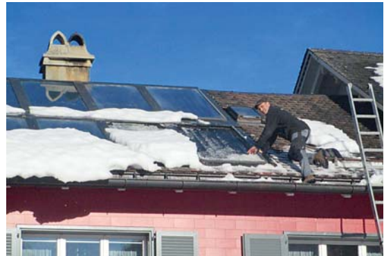
Schneedruckschaden an Solarkollektor im Winter 2011/2012
