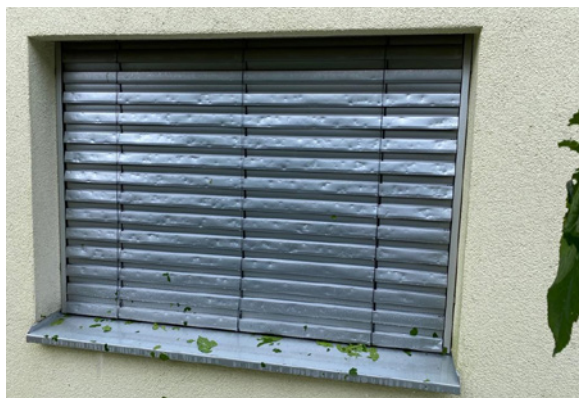
Massive Hagelschäden an Storen
