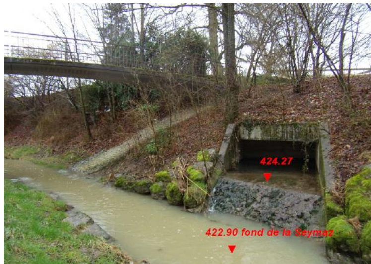
Figure 7 : Exutoire du collecteur EP D1250 (Source : Haller géomètre, 2009)
