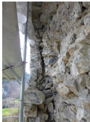
Abb. 2 Nördlicher Teil der Mauer – Ablösen des Sichtmauerwerk
