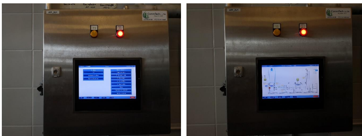
Figure 8 Panneau de contrôle du système d'alarme
