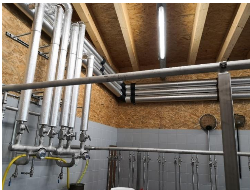
Figure 6 Tuyauteries dans la salle de production
