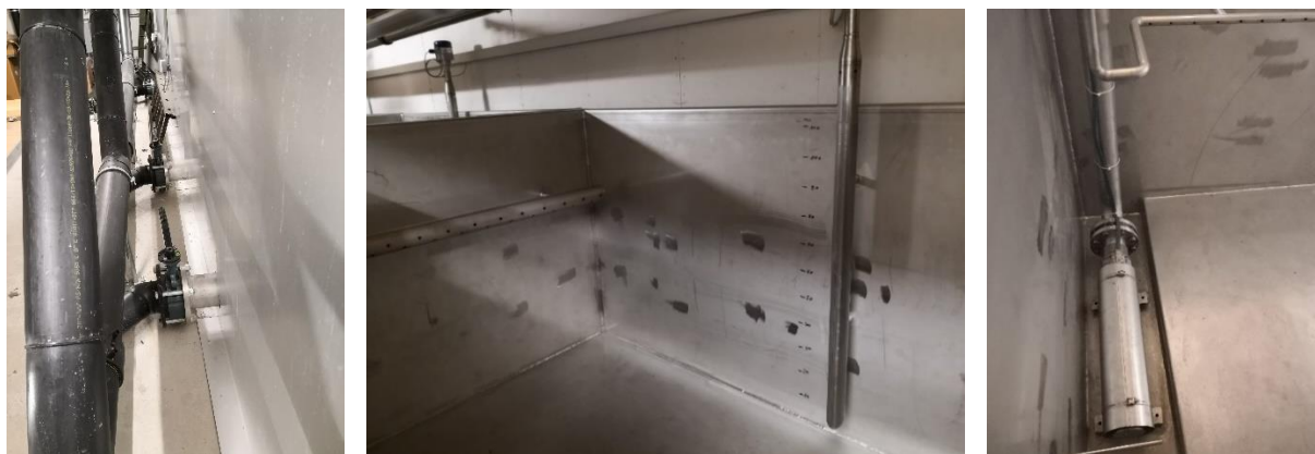
Figure 4 Cuves de réserve d'eau
