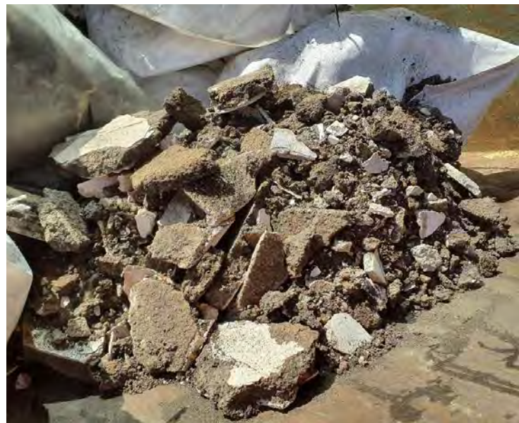
Schadstoffhaltige Bauabfälle Bild: AWA
