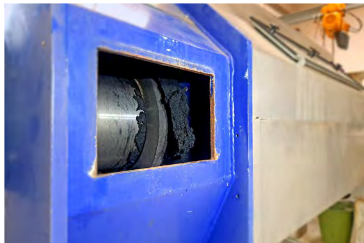
Schlammmentwässerung Bild: ARA Meiringen
