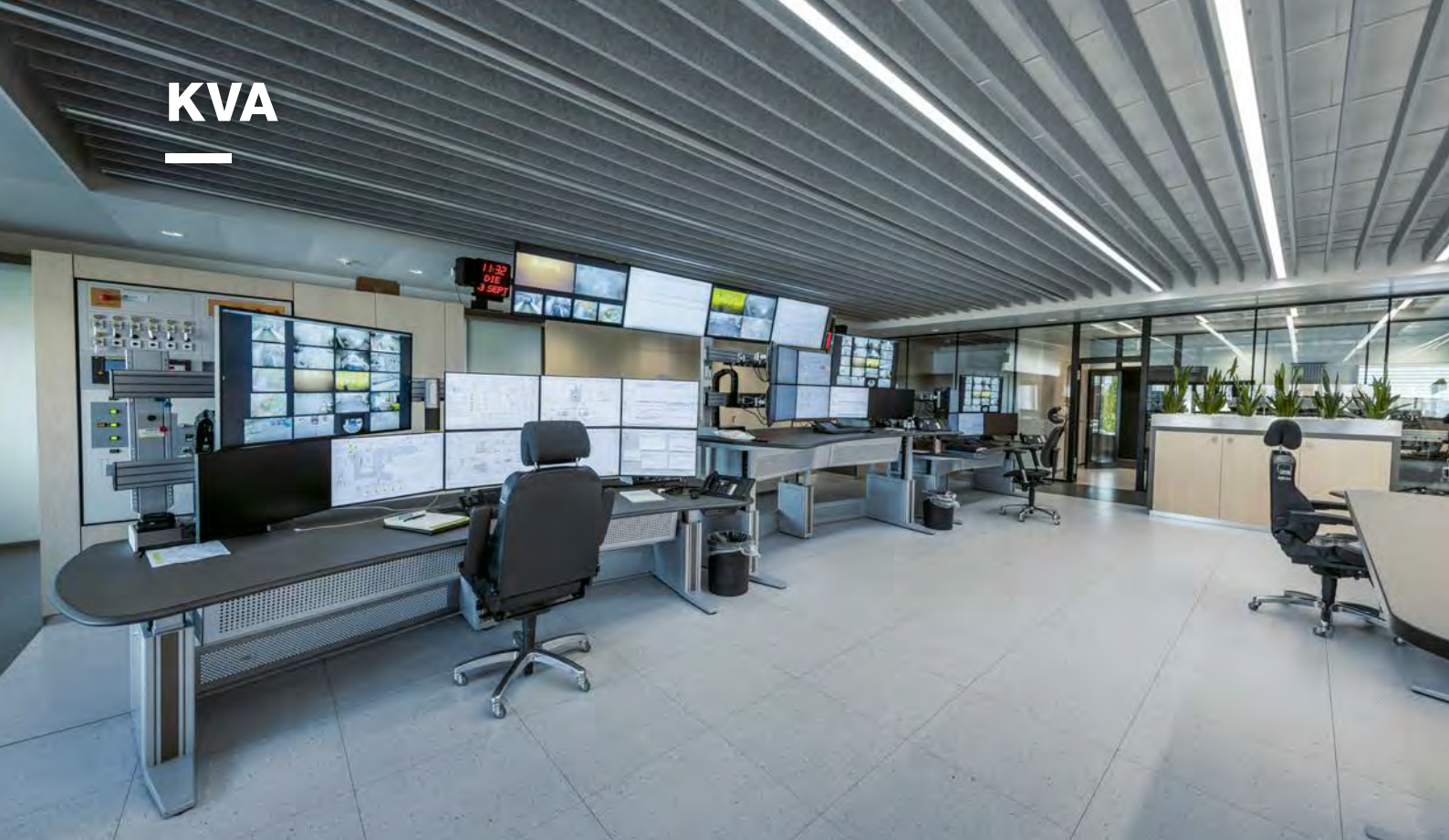
Kontrollraum Bild: AVAG Umwelt AG
