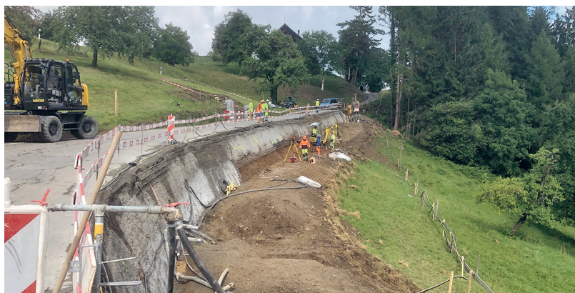
Bild 10 Wolfhalden, Haslistrasse, Unterlindenberg - Vorderhasli, Baustart 2025. Kurzfristiger Ersatz für P 1541, Hinterhasli - Kantonsgrenze auf gleicher Strecke
