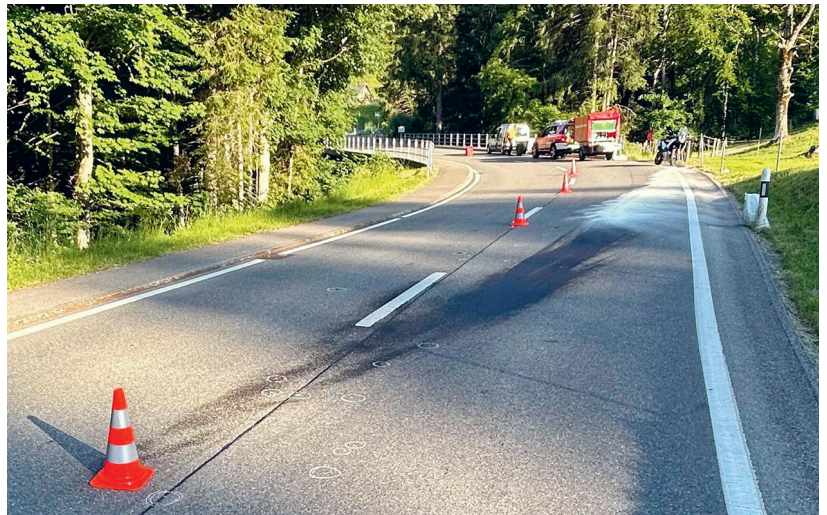
Bild 3 Kantonsstrasse Nr. 26, Urnäsch-Schwägalp. Auf der Schwägalpstrasse kommt es häufig zu Unfällen. Der Zustand der Strasseninfrastruktur wird bei der Unfallanalyse immer einbezogen.
