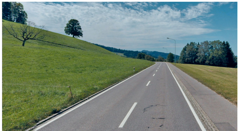
Bild 12 Kantonsstrasse Nr. 20, Herisau - Degersheim, Blickrichtung Ortsteil Schachen. Die heutige Verkehrsanlage ist zu schmal für einen Rad- und Gehweg im Zweirichtungsverkehr.
