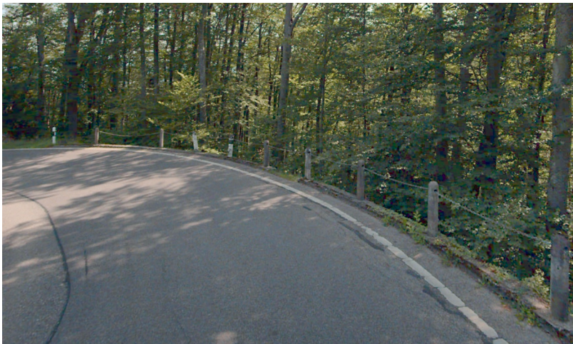
Bild 18 Marode Stützmauern an der Kantonsstrasse Nr. 51.3, Landegg- Thal im Ortsteil Wienacht.
