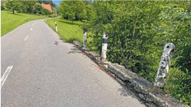
Bild 13 Marode Stützmauern an der Kantonsstrasse Nr. 51.3, Landegg- Thal im Ortsteil Wienacht.
