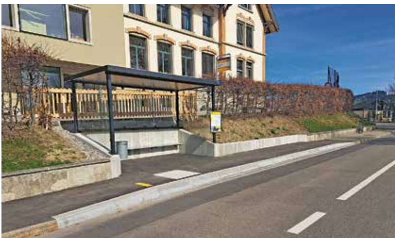
Bild 3 Bushaltestelle vor dem Schulhaus Dorf in Rehetobel, Umbau im 3. Quartal 2022 in enger Zusammenarbeit zwischen Tiefbauamt und Gemeinde.
