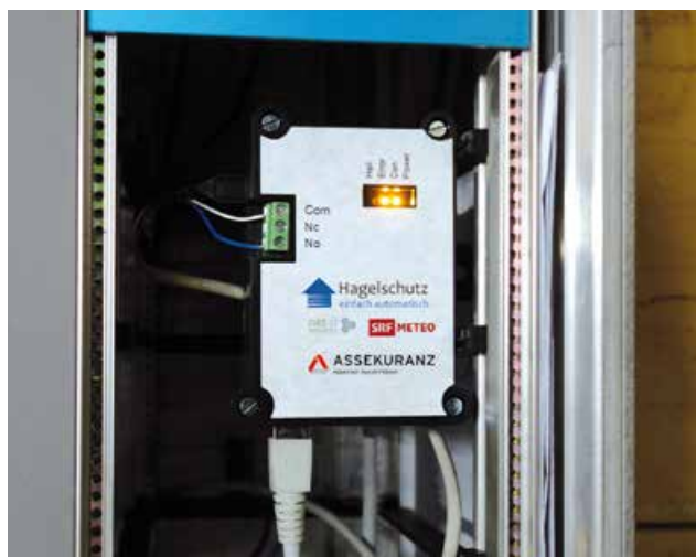
Steuerungseinheit für den Hagelschutz
