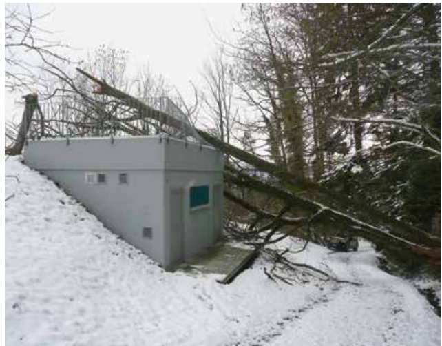
Sturmschaden in Lutzenberg
