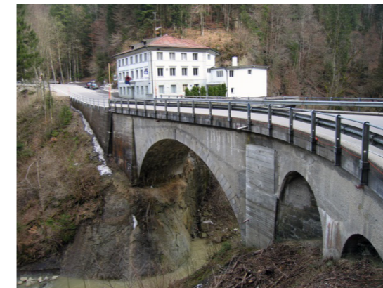
Bild 14: Zweibrücken, vorne die Goldachbrücke und hinten in der Kurve die Holderenbachbrücke. Letztere stammt aus dem Jahre 1848 und muss dringend ersetzt werden.
