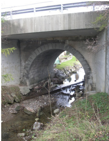
Bild 13: Rotbachbrücke Gais, ungenügendes Durchflussprofil und Schäden an der Bausubstanz des Brückenbogens erfordern Massnahmen.
