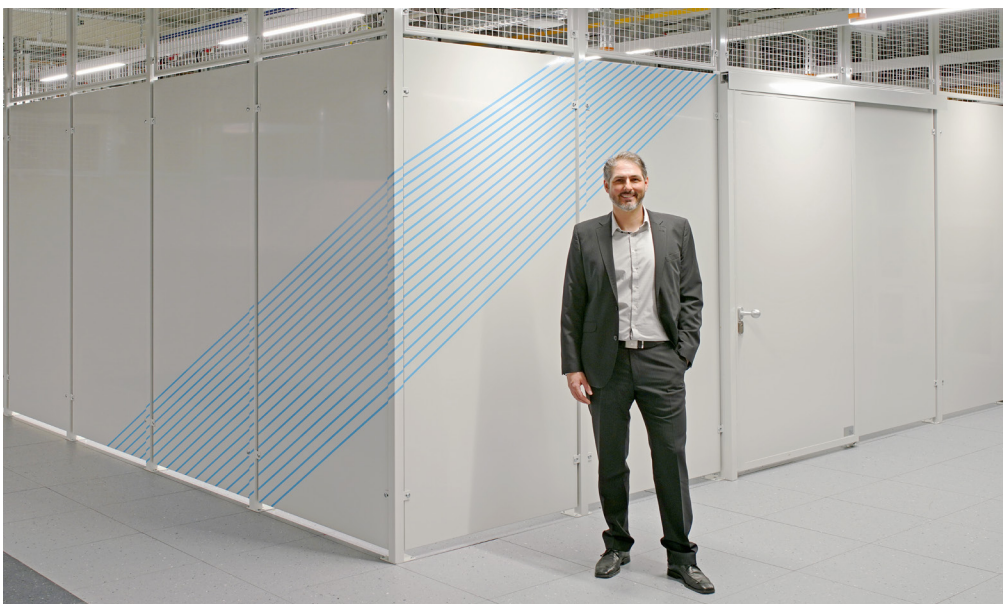
Marcel Zoller, Leiter Infrastruktur vor dem Cage im Rechenzentrum Ostschweiz
