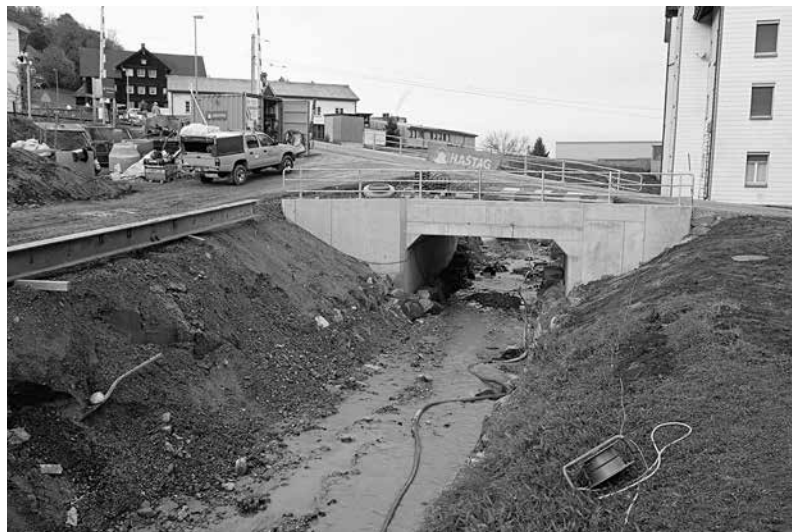
Objektschutz grösserer Durchlass
