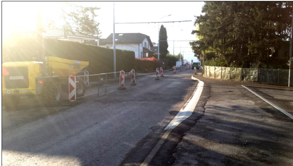
Figure 6 – Exemple de trottoir traversant en cours de réalisation (Ch. Grand-Champ x Rte du Bois-des-Frères)
