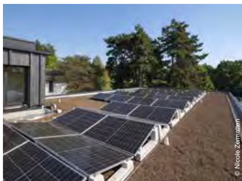
Pavillons Trembley – Panneaux photovoltaïques
