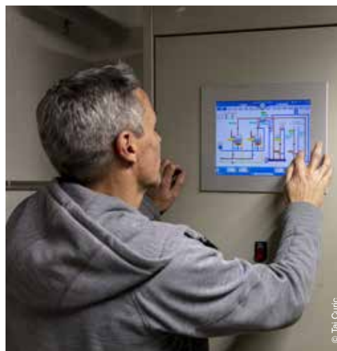
Régulation dynamique du chauffage
