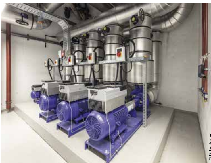
Chauffage à distance au Seujet
