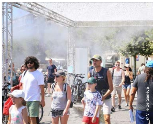
Brumisateurs installés à Plainpalais
