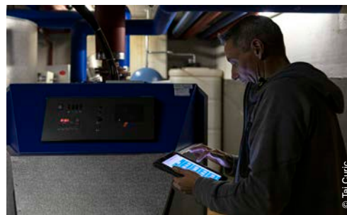
Chaufferie Ernest-Pictet 10/12: Contrôle des données de production de chaleur
