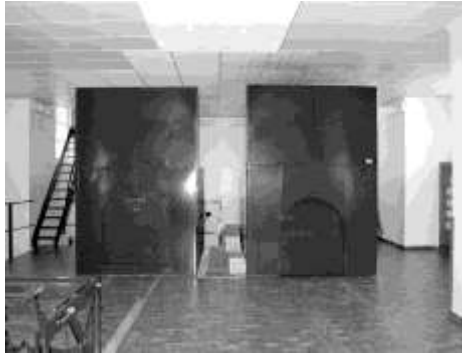
Photo des deux fours électriques (N°1 à gauche, N°2 à droite)
