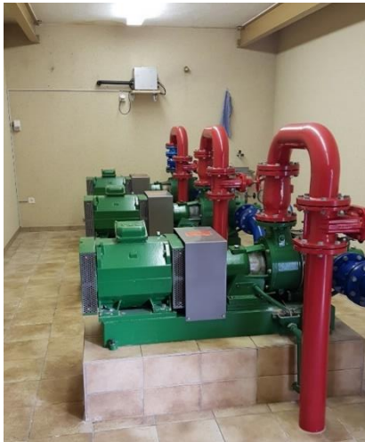
Station de pompage de a Malakoff : intérieur
