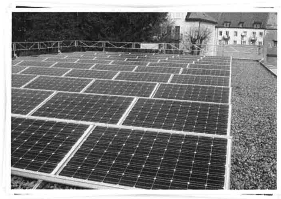
Figure 13 Les énergies renouvelables représentent des ressources primordiales pour le futur. A La Chaux-de-Fonds, elles occupent une place importante pour les planifications énergétiques de la ville, à l'image du premier réseau de chauffage à distance qui a été mis en fonction en 1926 et des panneaux solaires implantés sur les toits des immeubles, comme ici sur le collège de Bellevue.
