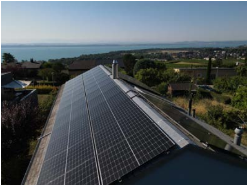
Figure 13 : Exemple d'une installation BAPV à Milvignes dans le Canton de Neuchâtel (source : Eligreen, Bevaix)
