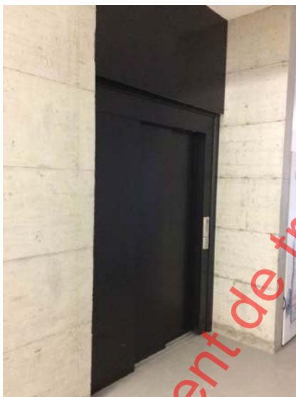
Ascenseur Aile Sud
