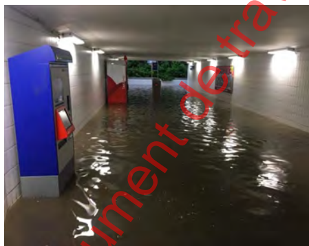
Fig.30 - Photo illustrant les notions « d'aléas climatiques » et de « surverses » et les conséquences pour les situations de passages souterrains, ici lors d'un orage en Ville de Sion [Le Nouvelliste, 2016]
