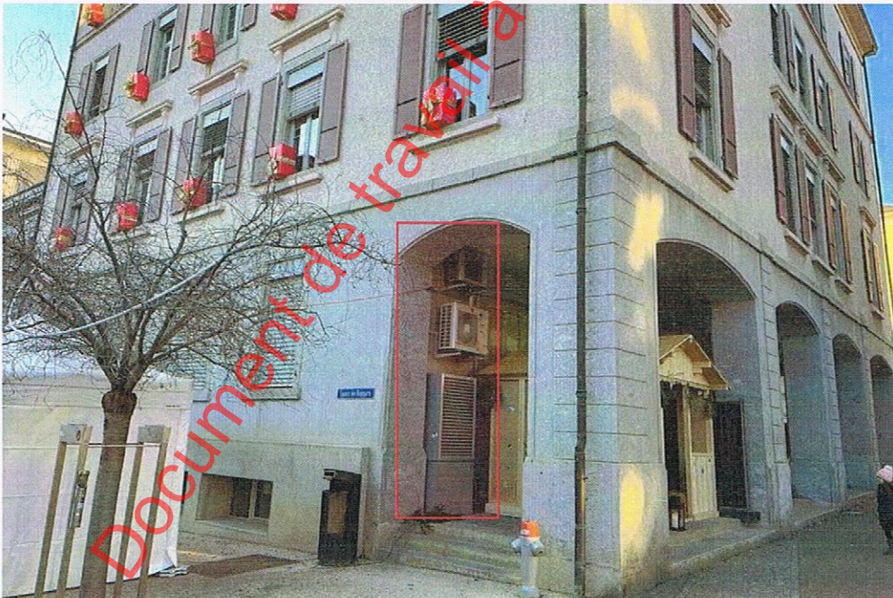
Image n°4 : Bâtiment administratif communal, qui abrite le Service des Bâtiments et Constructions, à l'angle des rues de Lausanne et des Remparts. Installations techniques du bâtiment sans intégration au bâti et à son environnement, offertes à la vue de tous.
