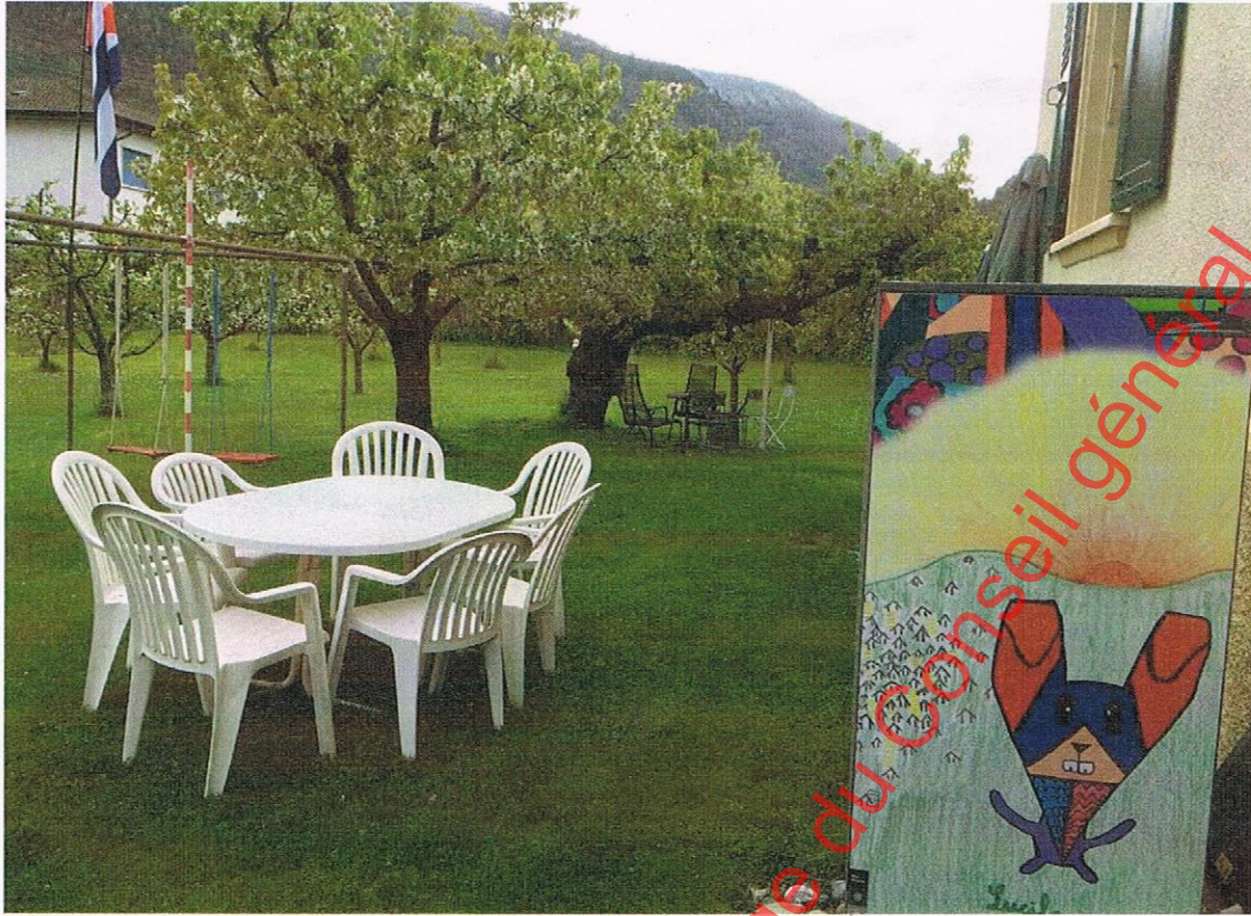
Image n°3 : Villa à Bramois, rue de la Blantsette. Maison entourée de vergers, avec PAC invisible depuis la route et les maisons environnantes. Le sommet et les côtés de la pompe à chaleur ont été peints par les petits-enfants des propriétaires afin de l'intégrer à son environnement (espace de jeu : toboggan et balançoires). Projet autorisé et contrôlé par le Service des Bâtiments et des Constructions. (Photographie publiée avec l'accord des propriétaires).
