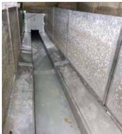
Déversoir d'orage de Salins
