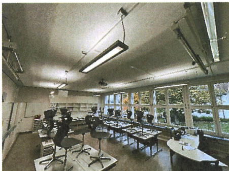
Umrüstung der bestehenden Leuchten
