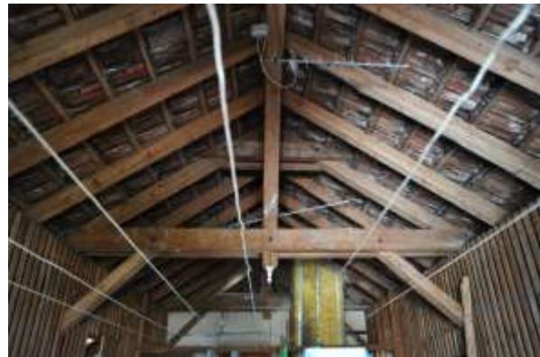
Abb. 71: Dachgeschoss, Dachwerk mit Hängesäule im 2. DG die von einer Kehlbalkenzange umschlossen wird (Q2 sowie im Hintergrund Q3).
