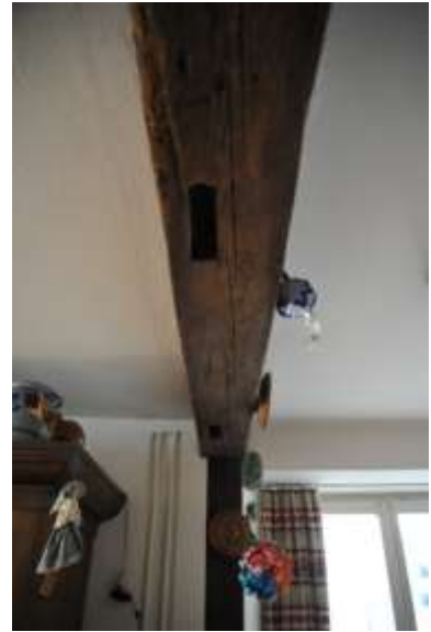
Abb. 55: Küche 005 mit Nebenstube 004, das Holzgerüst zeigt Zapflöcher des ehemaligen Fachwerks. Die Hölzer entstammen dem Vorgängerbau von 1819. Blick nach Westen.
