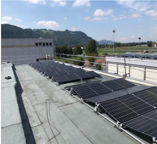
Neue PV-Anlage auf Turnhallendach
