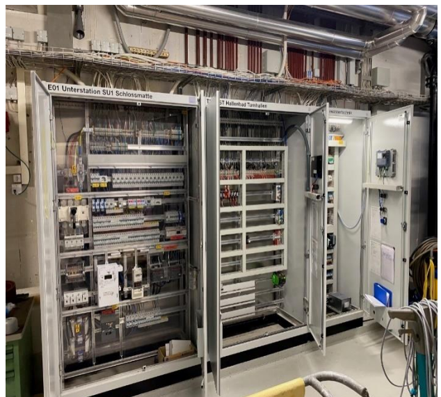
Neue Elektro- und Steuerungsanlage
